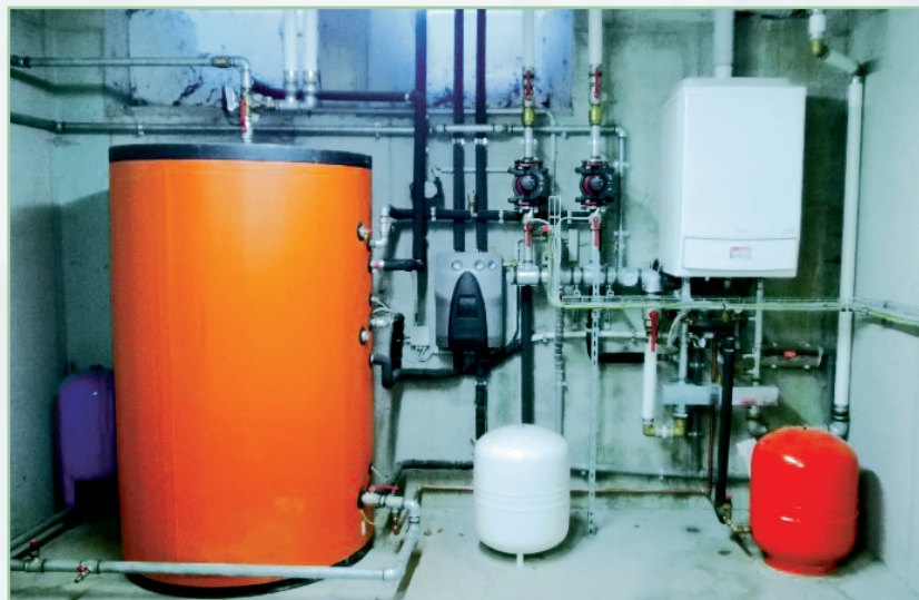
Impianto in passato senza KSI
